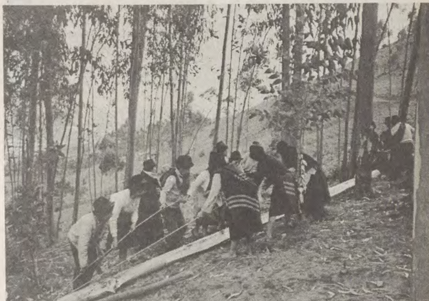
De minga is de gratis gemeenschapsdienst. Eén dag op de week werken de indianen voor een gemeenschappelijk projekt. Hier is men een weg door een bosje aan het aanleggen.
